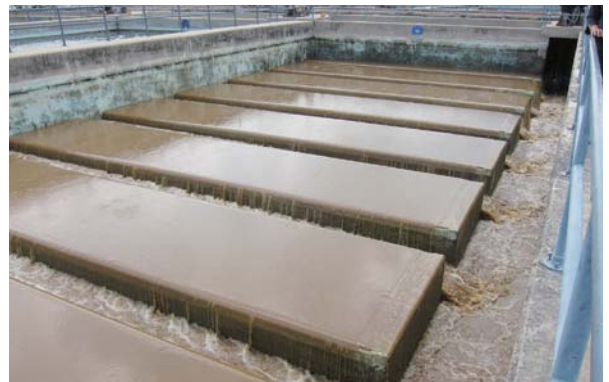
MWAのバンケン浄水場の洗浄中の急速ろ過池
